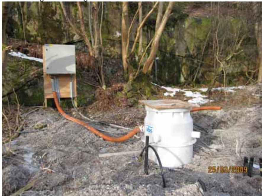
VA-anlegg med pumpestasjon og styringstavle
