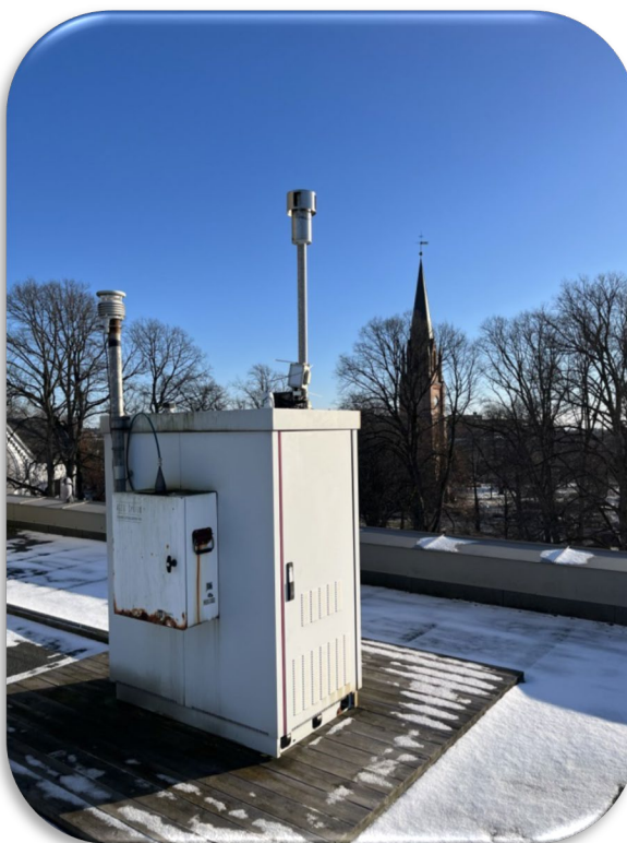
Foto 3 Bybakgrunnstasjonen på taket av Rådhuset i Nygaardsgata. Foto: Stine Syvertsen
