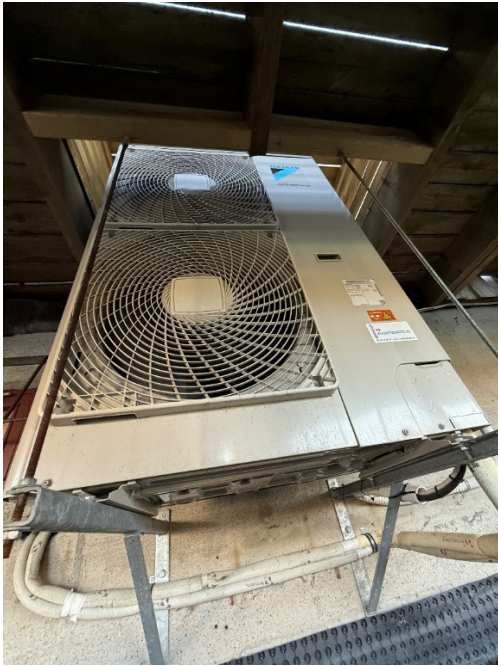
Bilde av: Varmepumpe på taket av klubbhuset
