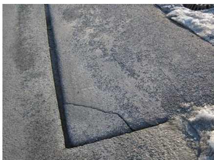
Uriktig utført asfaltskjøt uten fortanning
