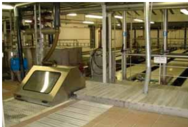
Figur 8. Maskinrist og sand- og fettfang i avløpsrenseanlegg.
