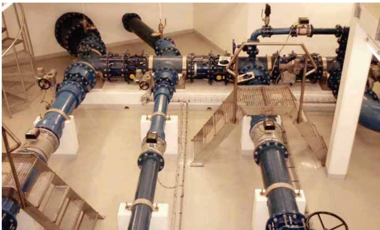
Figur 11. Ventilhus på ringledningen ved Haldenveien. Ventilhuset fjernstyres fra Driftssentralen.
