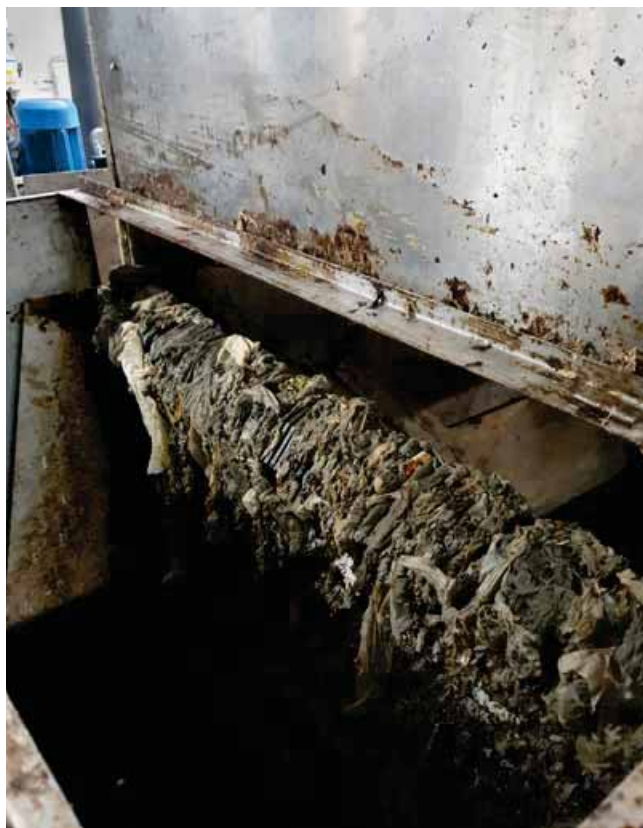
Maskinrenset rist på FREVAR.
