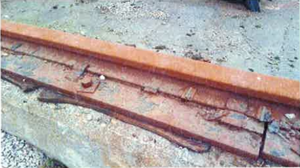
Kranskinnen mangler feste arr. Bolter er rustet. Tilstanden er ikke sikker.
