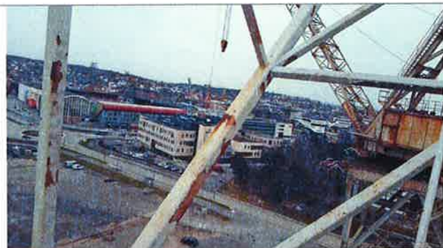
Detalj av bom. Typisk rust angrep
