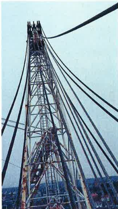
Wisbech-Refsum kran Bom sett fra tak maskinhus
