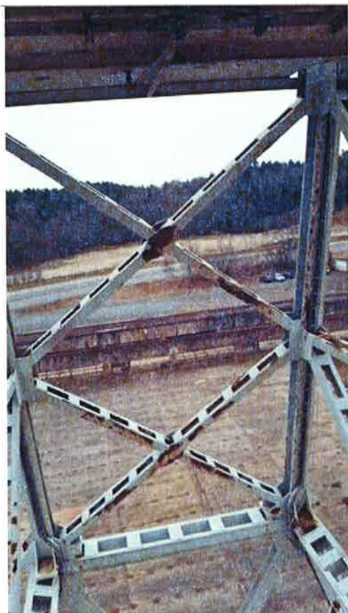
Nedre struktur kran.
