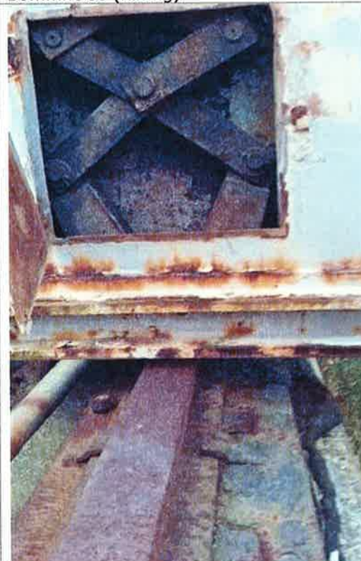
Bilde viser enden på boggiene og låse arrangement, som ikke er i bruk.
