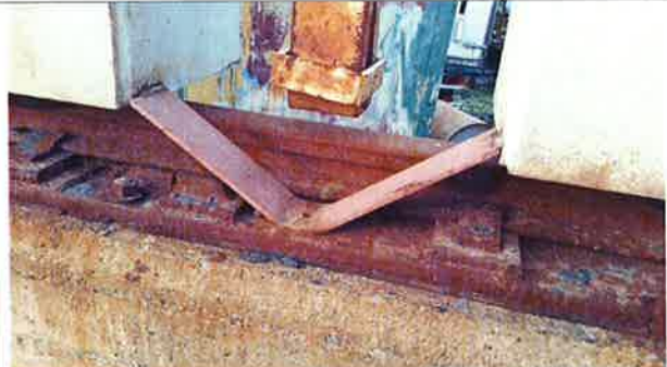
Låsing av kran
