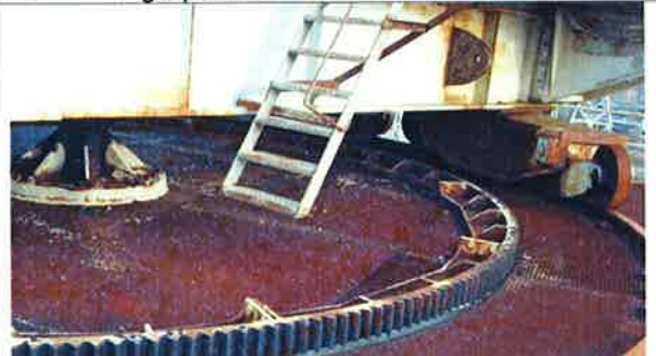
Svingramme, under maskinhus. Dørken er opprustet, farlig å bevege seg utpå.
