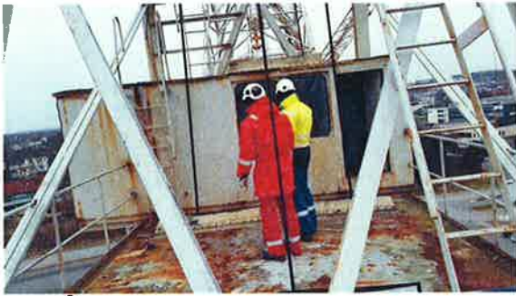
Tak på maskinhus.
