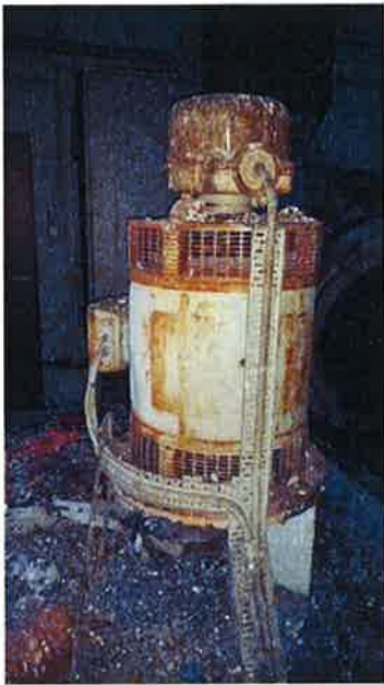
Sving maskineriet, helt fast rustet. Legg merke til Due møkk.
