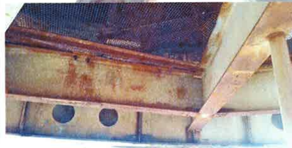
Undersiden av svinglager etage. Vanskelig å overflate behandle, mange lukkede romm.
