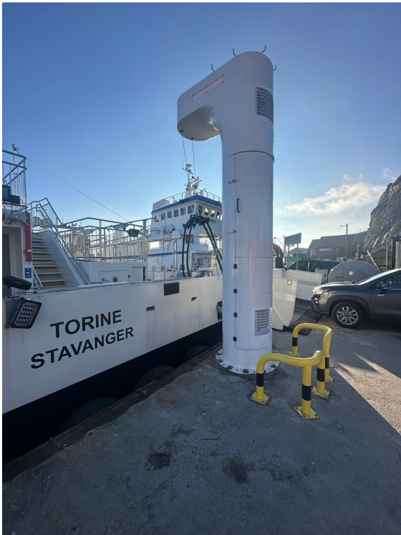
Den nye elektrisk fergen M/S Torine og ladetårnet på Skjærhalden. Foto: Oddbjørn Bergøy, SEAM AS.
