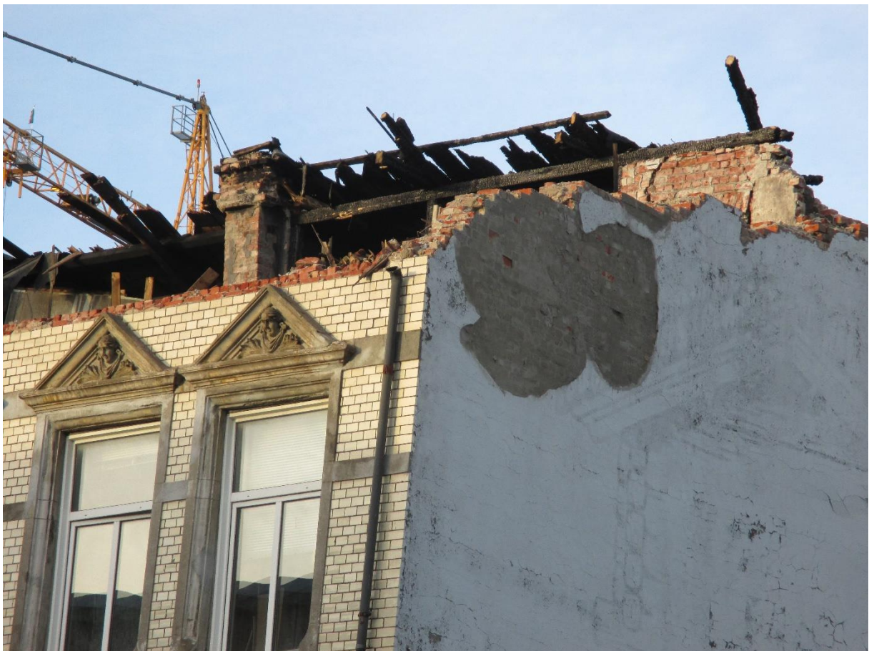
Alt kan ikke reparereres
