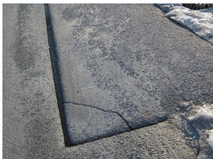
Uriktig utført asfaltskjøl uten fortanning
