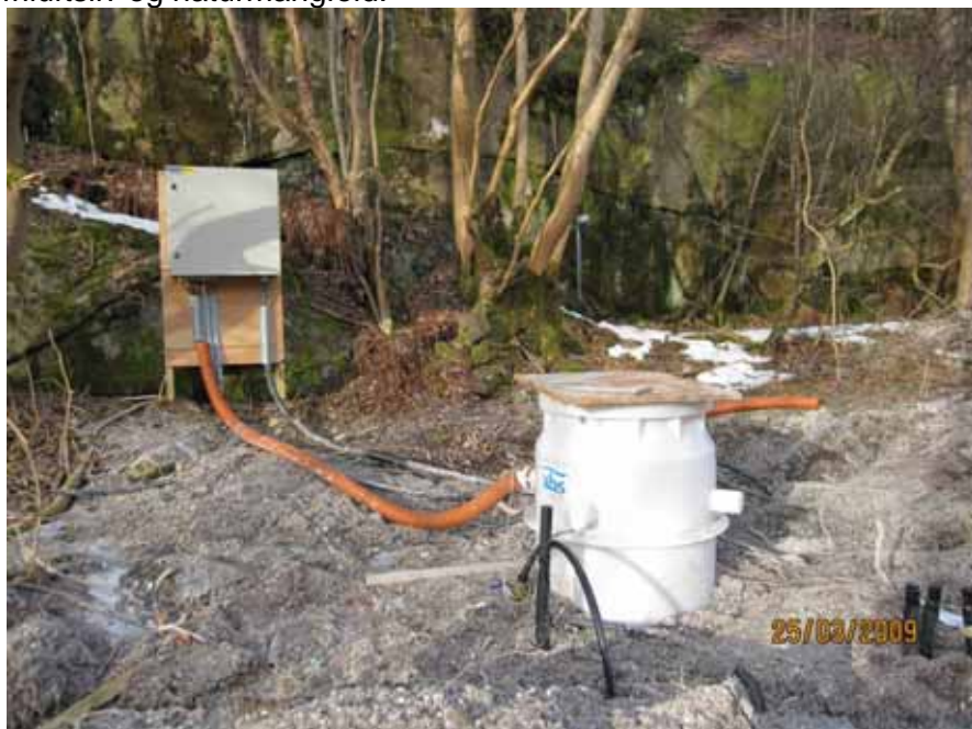
VA-anlegg med pumpestasjon og styringstavle
